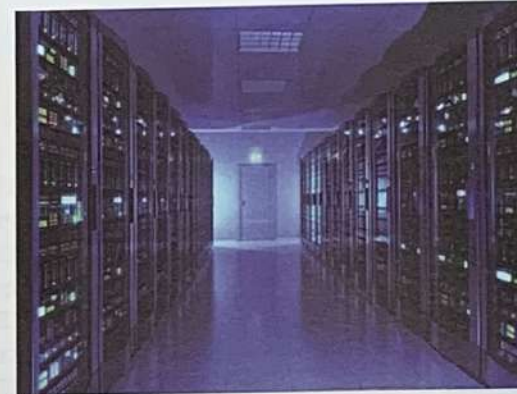
Interior de un servidor.
